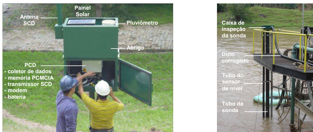
Figura 2 – Detalhes da instalação da PCD de qualidade de água
