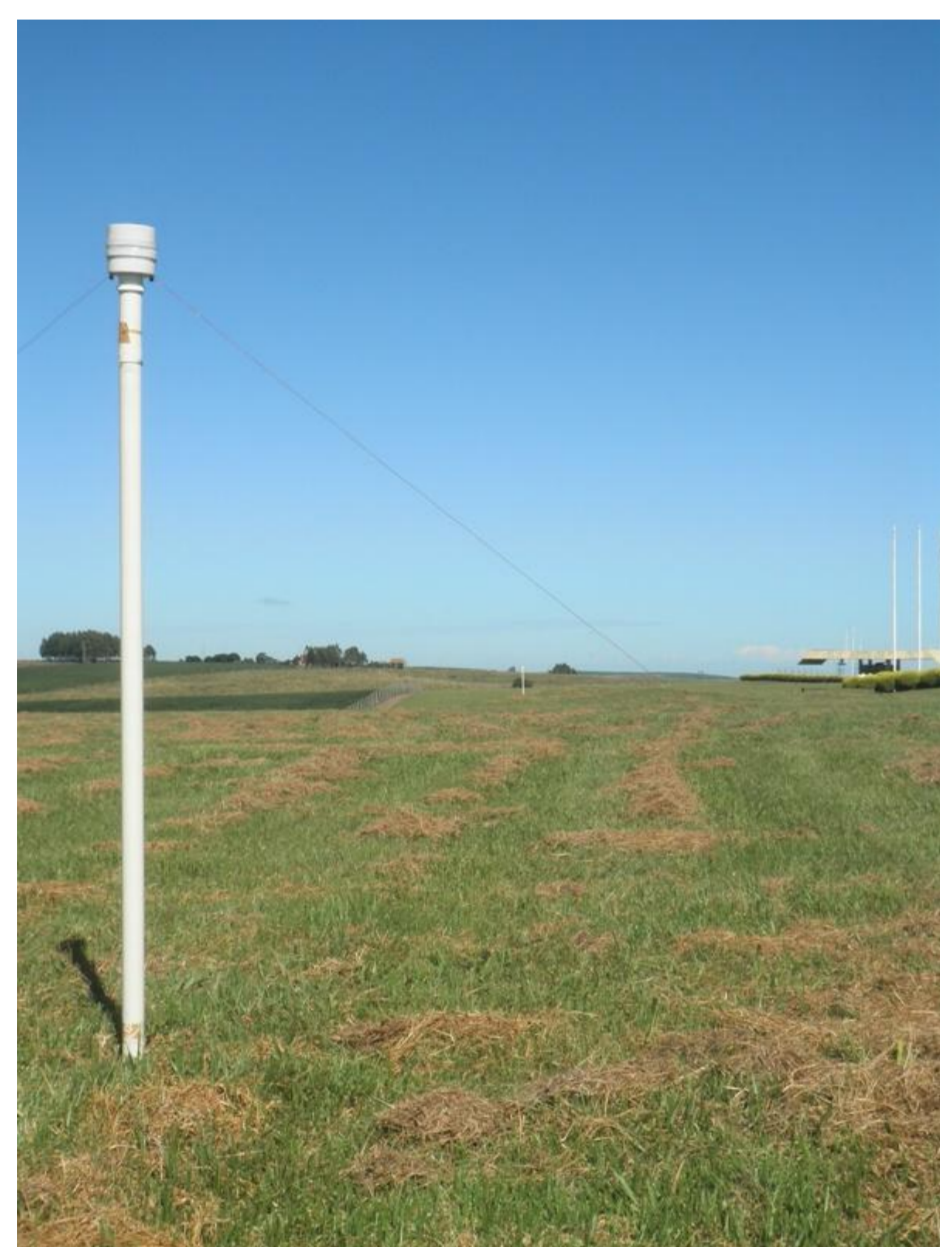
Fig. 1 – Antena instalada no OES.
