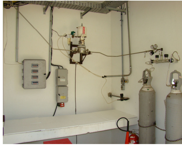
Linha de Combustível - Baia gasosa.
