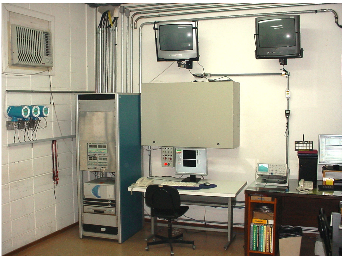
Figura 2.2 - Sala de Controle.
