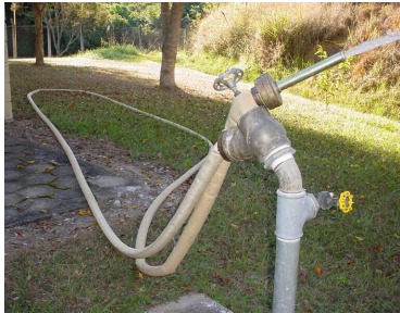
Mangueira no hidrante.
