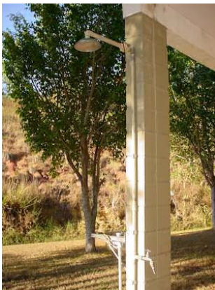
Chuveiro e lavador de olhos.
