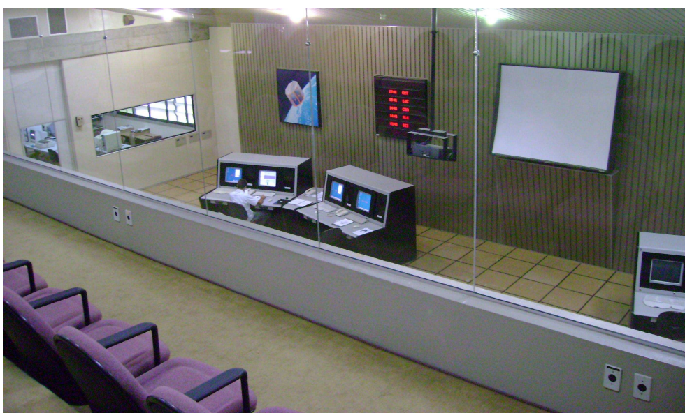
Figura 2 - Vista parcial da sala de controle principal do CCS. (Fonte: Orlando & Kuga, 2007)
