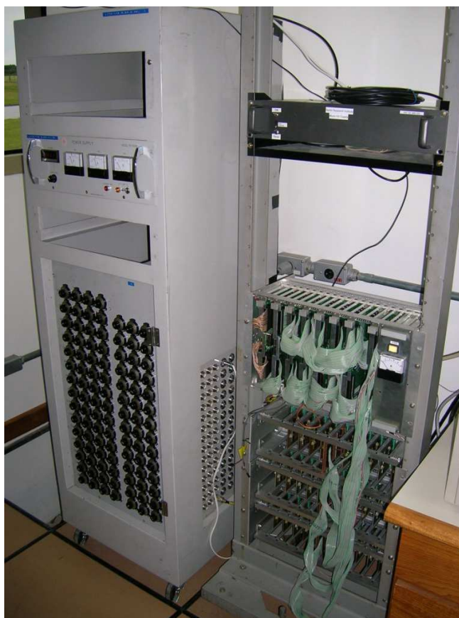
Figura 26 – Racks que suportam os potenciômetros, sistemas de processamento de dados e fontes de baixa e alta tensão.
