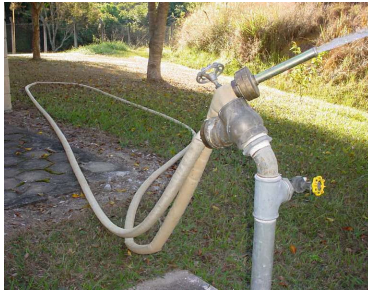
Mangueira no hidrante.
