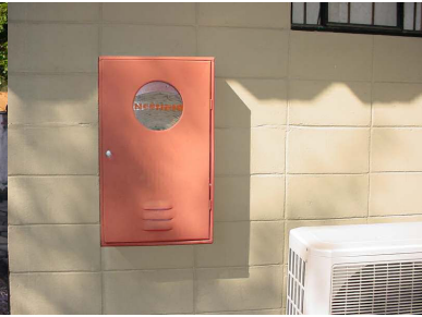
Caixa de mangueiras.
