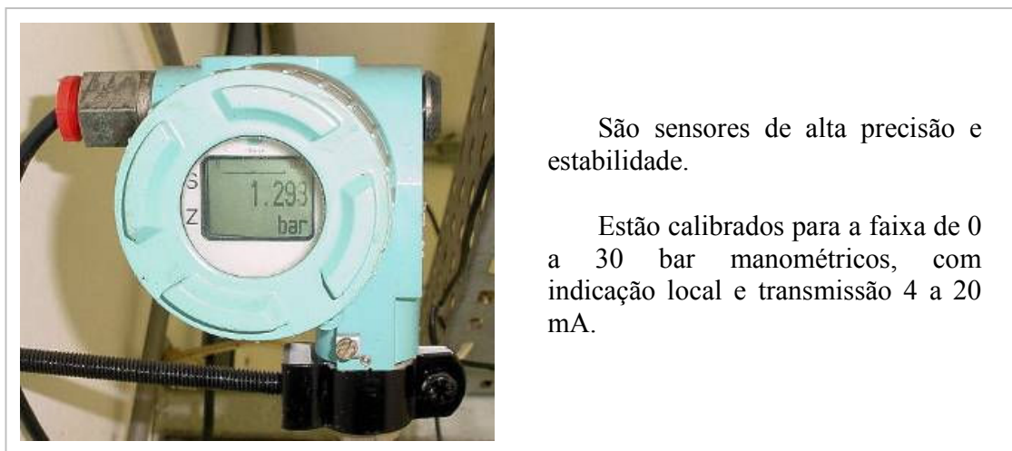
Figura 5.11 - Transmissor/indicador de pressão do tanque.
