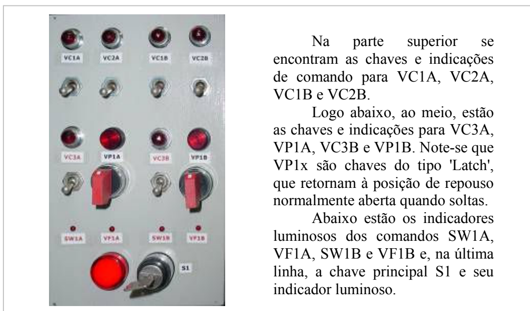
Figura 5.2 - Unidade de monitoramento e comando manual.
