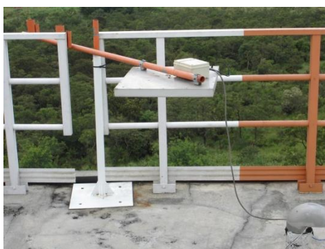
Figura 2.3. Sensor de campo elétrico localizado na torre.
