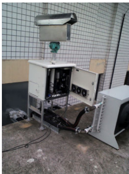
Figura 4.2 - Invólucro que protege os equipamentos. Equipamento que foi instalado na base da torre de telecomunicação da emissora de televisão Vanguarda em São José dos Campos.
