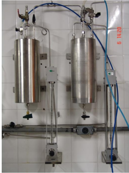
Figura 6.7 - Reservatórios para armazenamento de líquidos.
